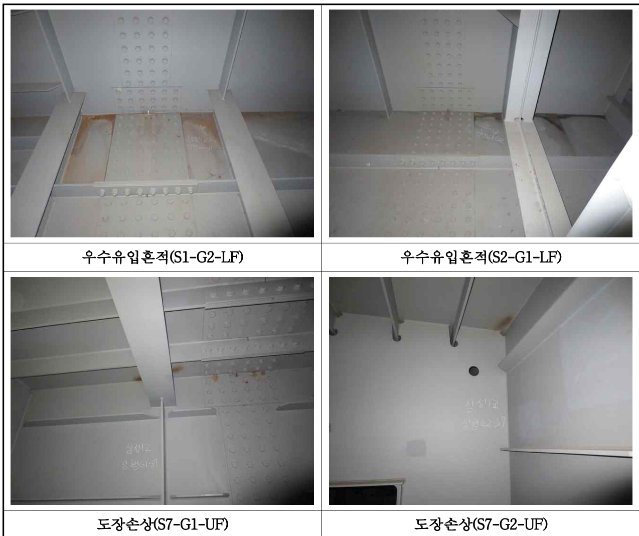
【사진 3.2.4】 강박스 거더 내부 손상현황(대구)
