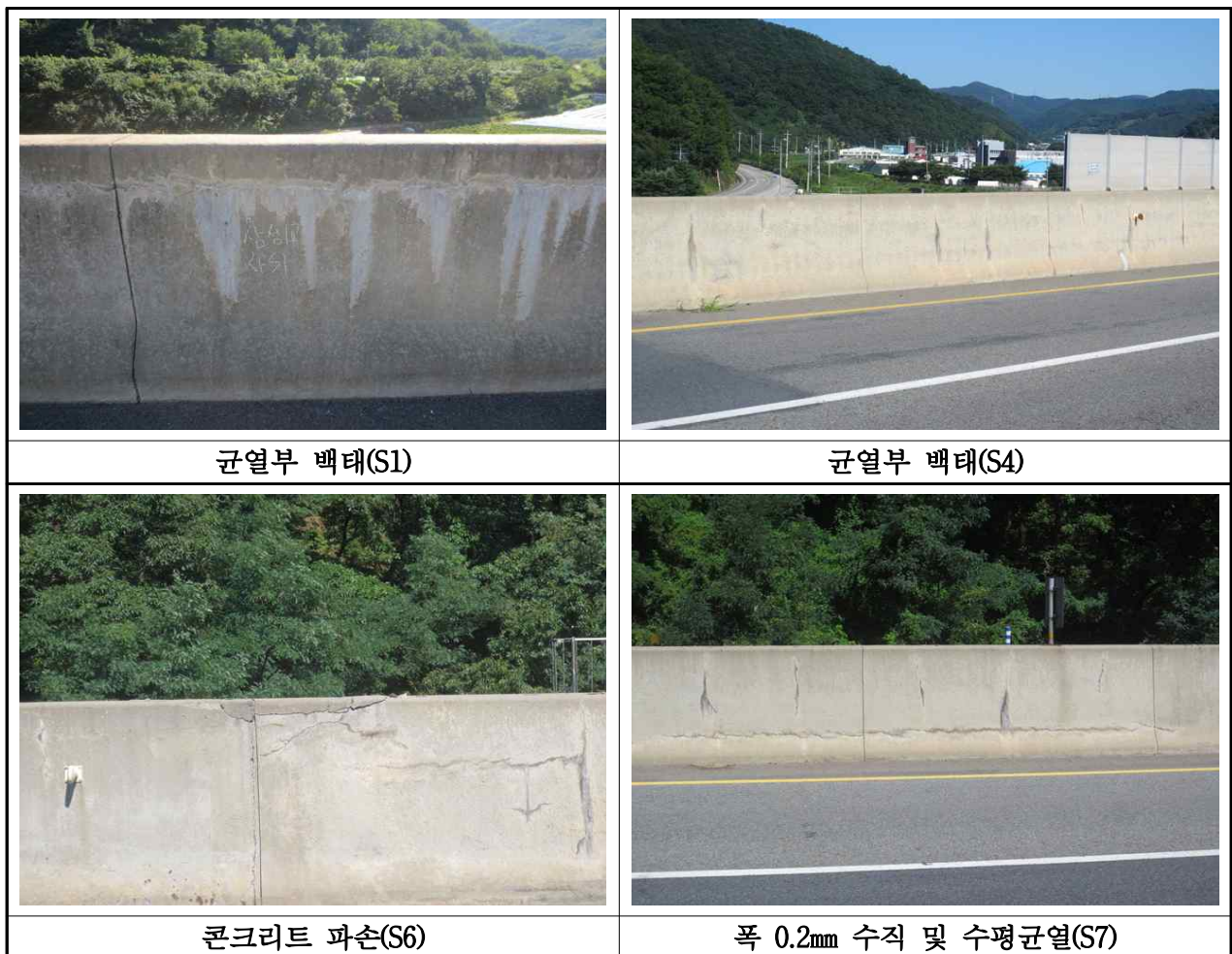
【사진 3.3.24】 난간 및 연석 손상현황(부산)
