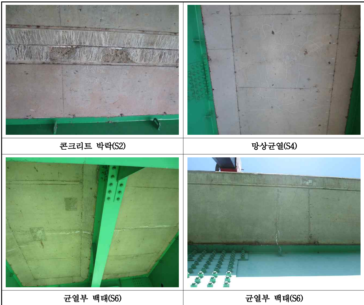
【사진 3.3.2】 바닥판 손상현황(부산)
