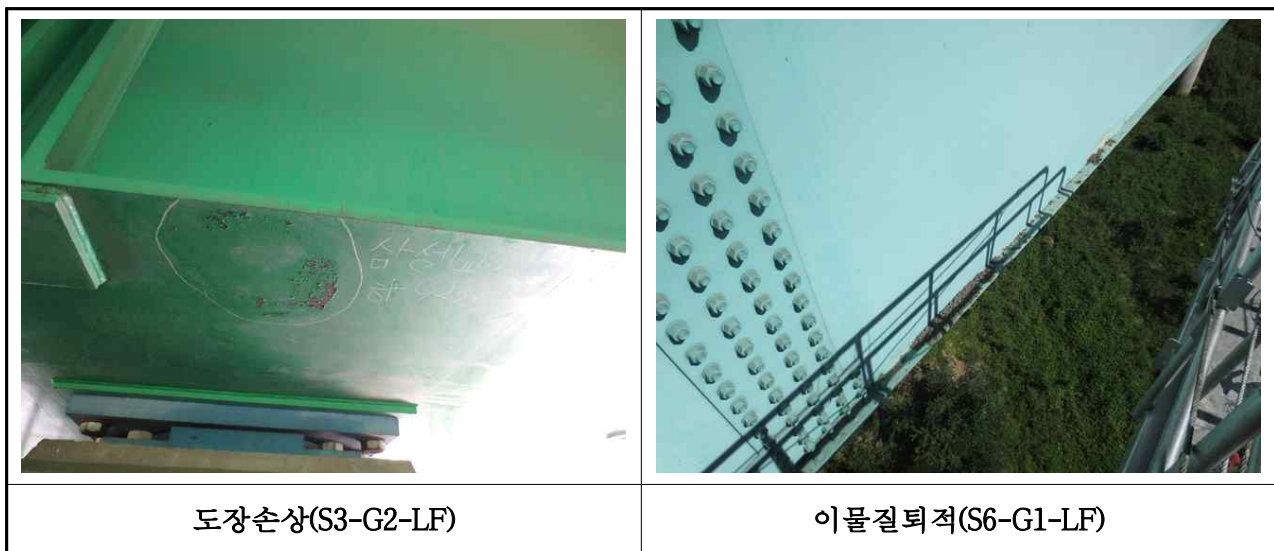
【사진 3.3.5】 강박스 거더 외부 손상현황(부산)
