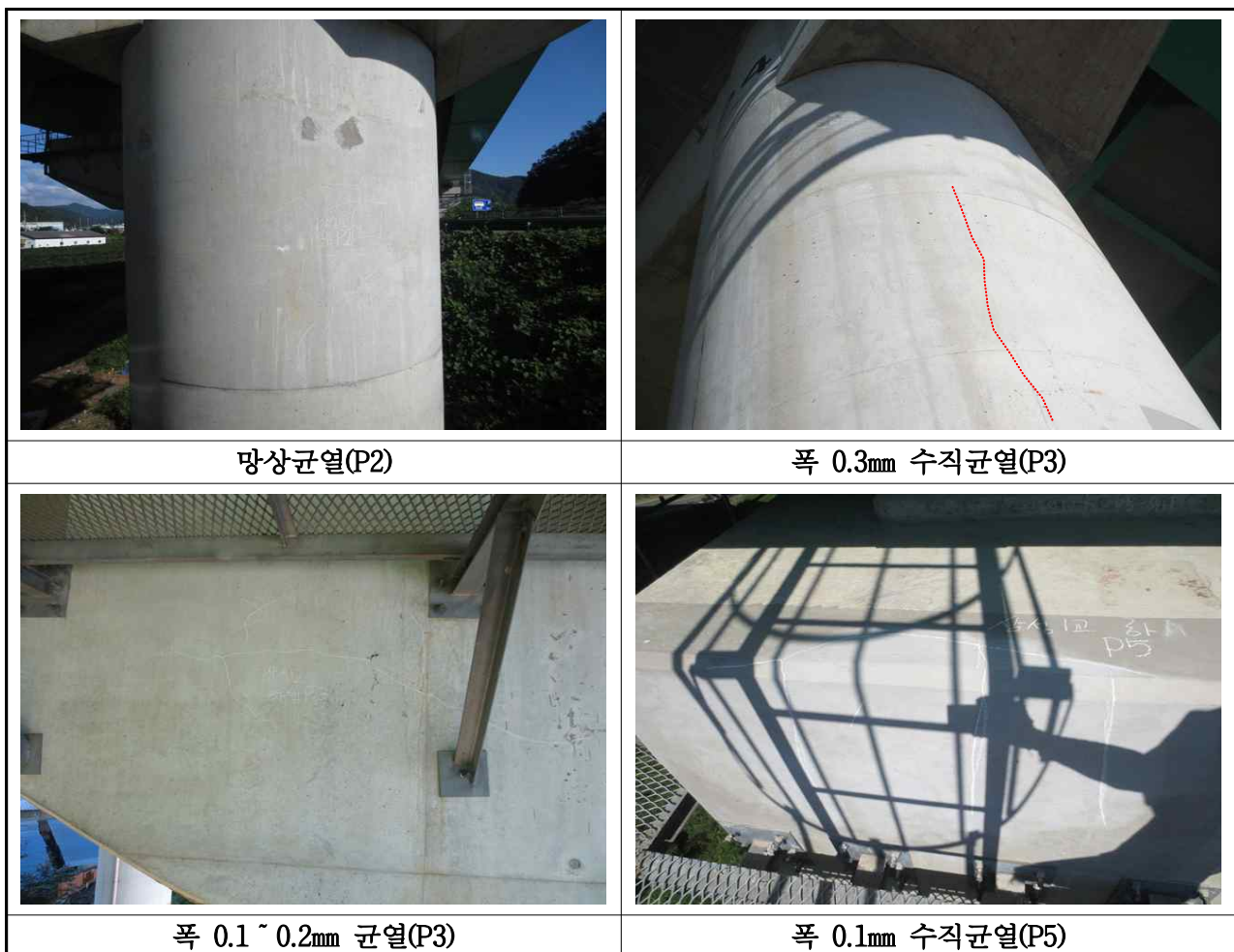
【사진 3.3.11】 교각 손상현황(부산)
