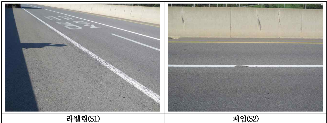
【사진 3.3.20】 교면포장 손상현황(부산)
