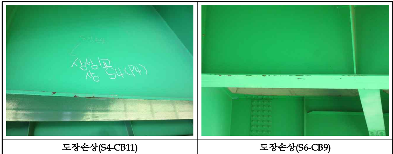
【사진 3.2.7】 가로보 및 세로보 손상현황(대구)
