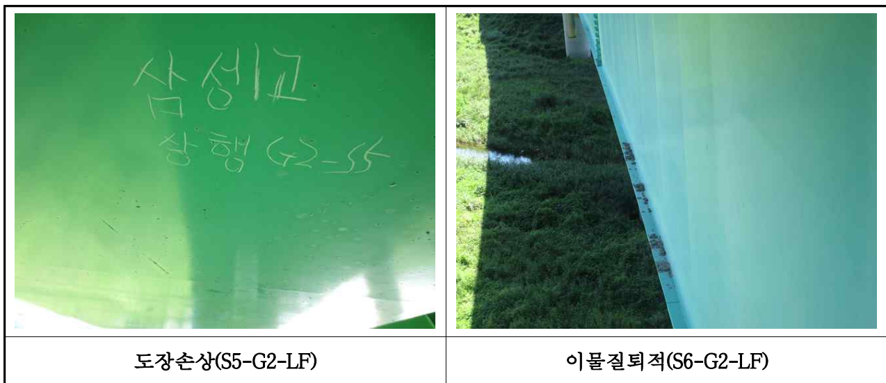
【사진 3.2.5】 강박스 거더 외부 손상현황(대구)
