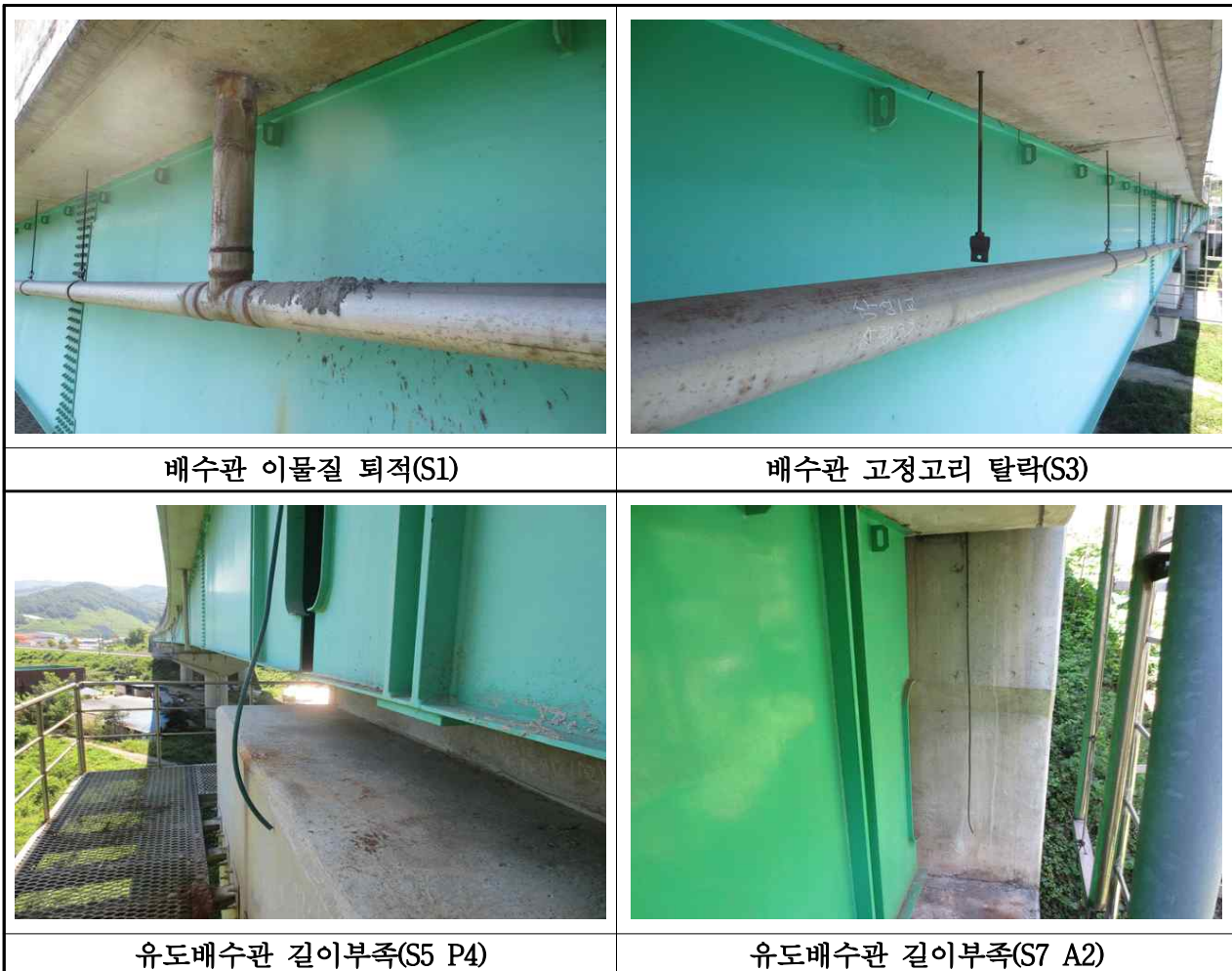
【사진 3.2.22】 배수시설 손상현황(대구)
