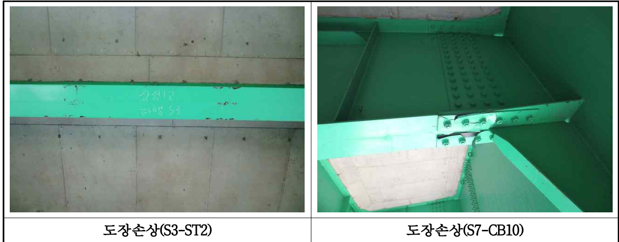
【사진 3.3.7】 가로보 및 세로보 손상현황(부산)
