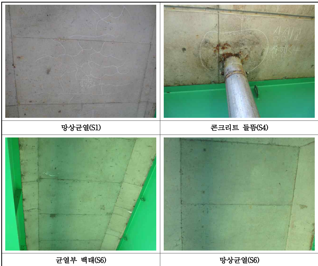
【사진 3.2.2】 바닥판 손상현황(대구)
