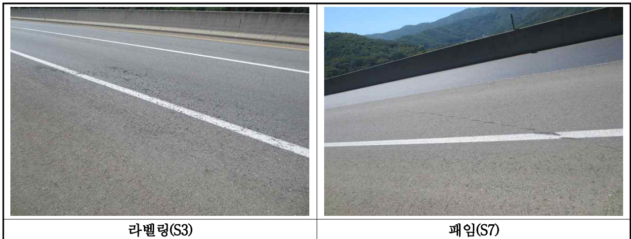
【사진 3.2.20】 교면포장 손상현황(대구)
